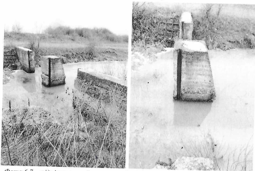
Фото 6,7 - підпірна споруда що потребує відновлення.
